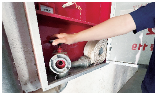
测试消火栓压力。
