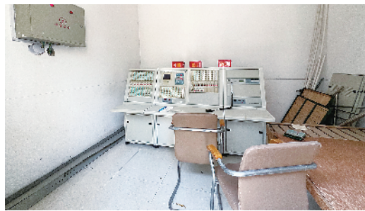
消防控制室无人值班。
