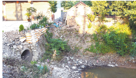
鹿邑县马铺镇 S207 道路东侧许庄标牌南约 200 米双兴不锈钢管门店旁沟内存在生活垃圾现象
