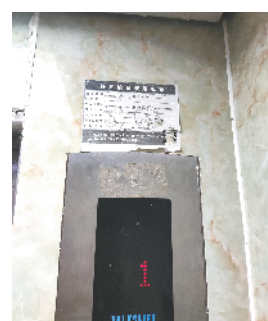
广电欣苑小区电梯使用标志破损
