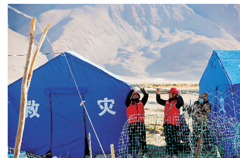
1月11日，在定日县措果乡塘仁村，国家电网日喀则供电公司的工作人员检查安置点的临时线路。当日下午，西藏定日6.8级地震震中区域安置点全部实现市电接通，电力供应更加稳定可靠。新华社记者 沈伯韩 摄
